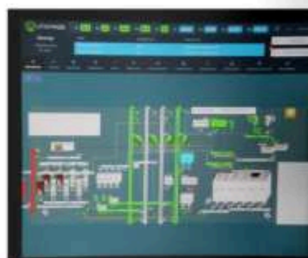
→ Un tableau synoptique et de commande permet de régir le silo depuis le pied de la tour de distribution.
